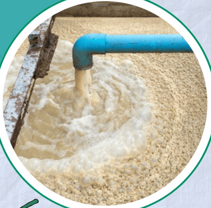
Instalasi Pengolahan Air Limbah 30,000 m 3 /hari
